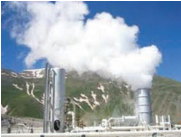
شکل ۱۲-۱۰ تصویر نیروگاه زمین گرمایی مشکین شهر
