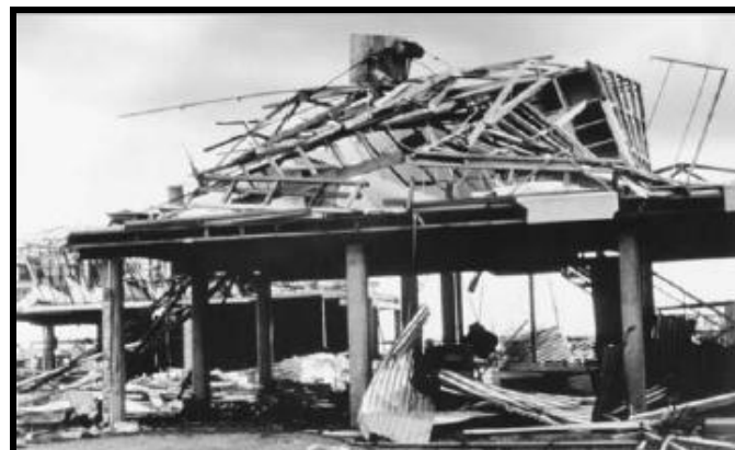
شکل ۳-۹ B - در موارد شدیدتر، تند بادهای کل ساختمان را تخریب و تنها بسترهای آهنی و ستون‌ها را به جای گذاشتند - (عکس‌ها از پرفسور جنوف بوقتان).
